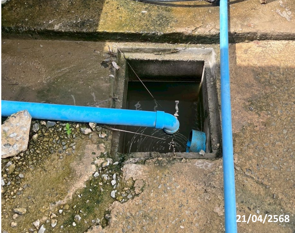
3. ตรวจสอบและทำความสะอาดบ่อดักตะกอนและบ่อฟักน้ำ
